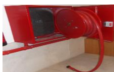
Figura 3.34. Boca-de-incêndio tipo carretel em armário (autor)
