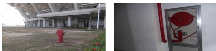
Figura 3.5. Estádio Nacional do Zimpeto, com hidrantes de incêndio (autor).
