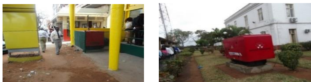
Figura 3.15. À esquerda gerador afeto a loja MCEL, na Av. Eduardo Mondlane, cidade de Maputo e à direita gerador afeto ao Concelho Municipal da Cidade de Xai-Xai (autor)
