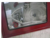
Figura 3.36. Boca de incêndio armada do tipo teatro (autor)
