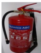
Figura 3.33. Extintor portátil de incêndio (autor)
