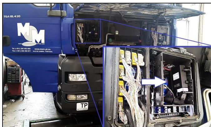
Figura 3.24- Controlador Blue Energy Diesel DNA instalado.
