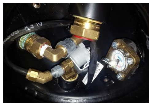
Figura 3.18- Componentes de controlo do depósito de combustível.
