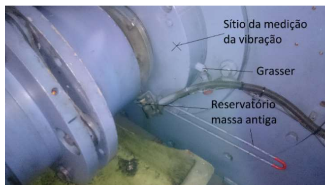
Figura 5.2. Componentes de lubrificação do rolamento e local de medida
