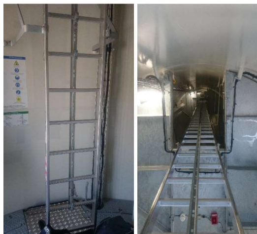
Figura 2.2. Escada de acesso à nacelle com sistema anti queda
