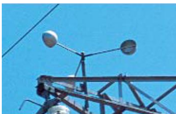
Figura 1: Anemómetros instalados pela REN nos apoios de traçados de muito MAT [2].
