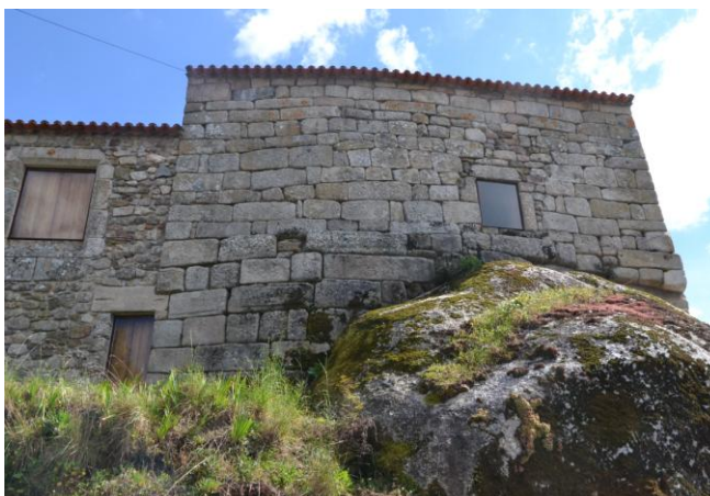
Fig. 118. Casa do Penedo. Fachada poente, salientando-se a qualidade do aparelho construtivo no sector inferior Noroeste
