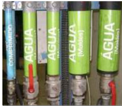
Figura 2.3 - Sinalização da tubagem na rede de abastecimento de água para consumo industrial.
