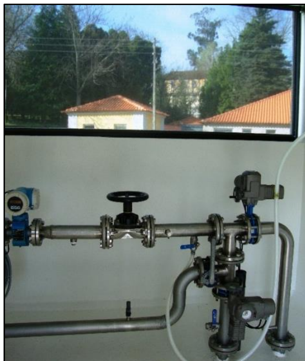
Figura 7.3 Zona de captação de água nas Caldas da Cavaca Fonte: Autor (2010)
