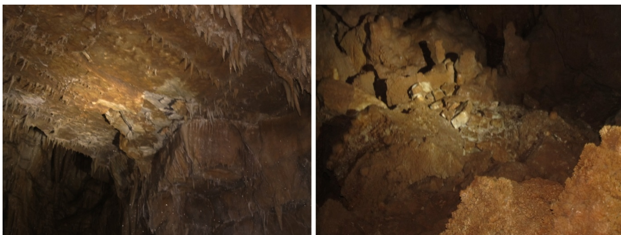
Figura 42 – Vestígios de colapso de uma parte do teto no setor inferior final: rocha a nu onde o destacamento ocorreu (esquerda) e o resultado do colapso no meio do caos de blocos (direita).
