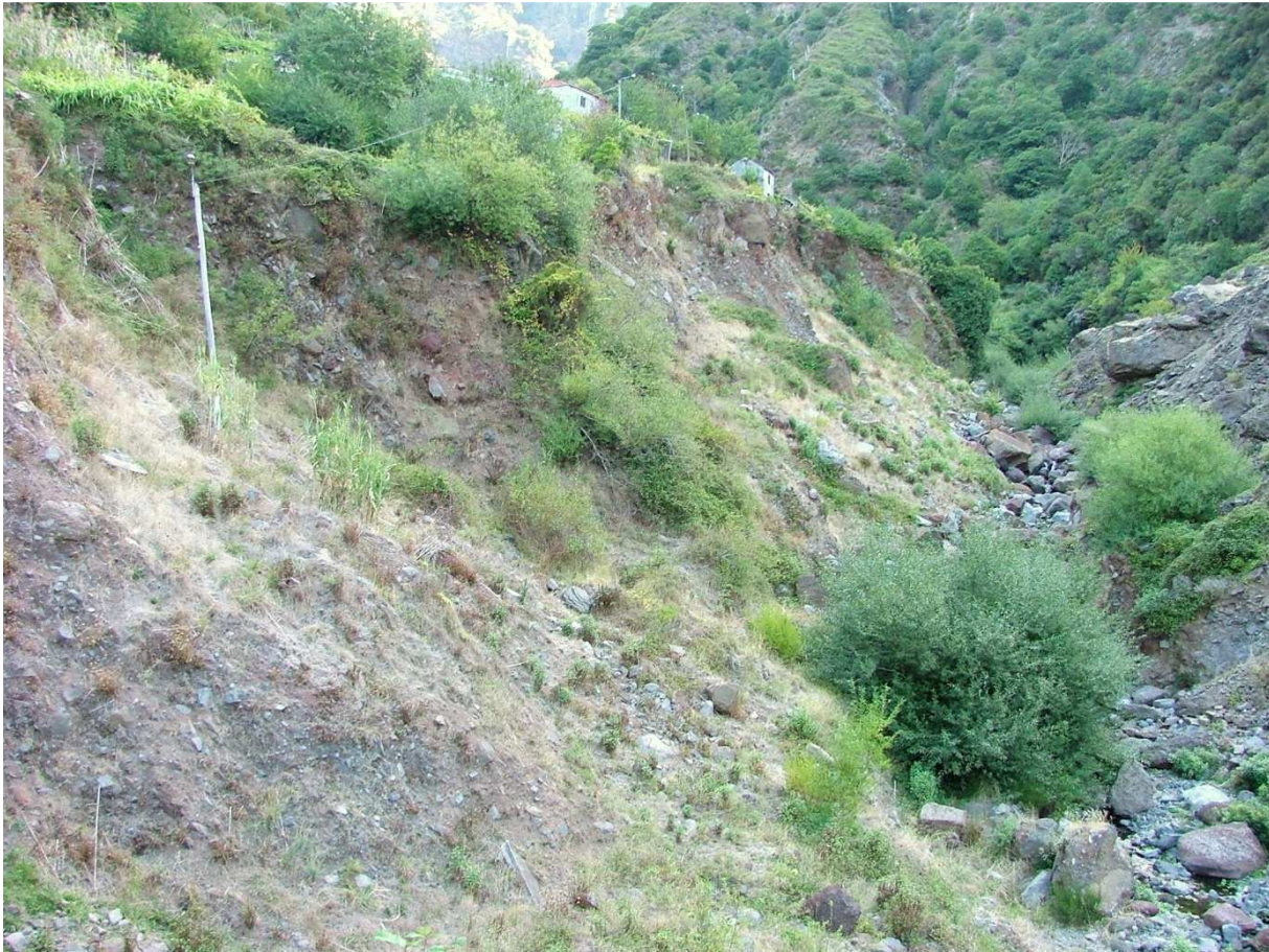
FIGURA V.25 Pico do Furão (Curral das Freiras), deslizamento rotacional na margem direita da Ribeira de Curral, num depósito de vertente consolidado.
