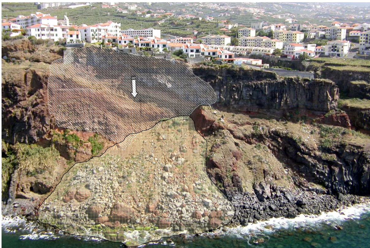
FIGURA V.15 Serrado do Mar (Câmara de Lobos), desabamento num talude costeiro (RODRIGUES, 2005).
