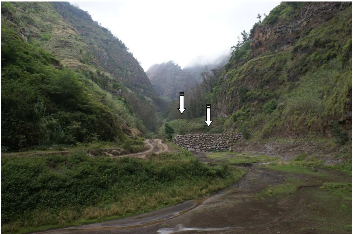
FIGURA VI.8 Ribeira dos Socorridos (Câmara de Lobos). Obstrução da linha de água, por um infra-estrutura de apoio a uma pedreira, determinando o aumento da severidade das cheias/inundações e a consequente vulnerabilidade a jusante.
