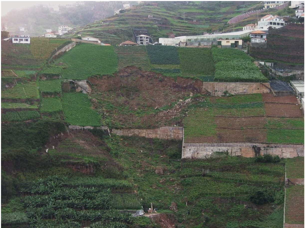
FIGURA V.26 Heras (Estreito de Câmara de Lobos), deslizamento rotacional, com uma forte componente antrópica.
