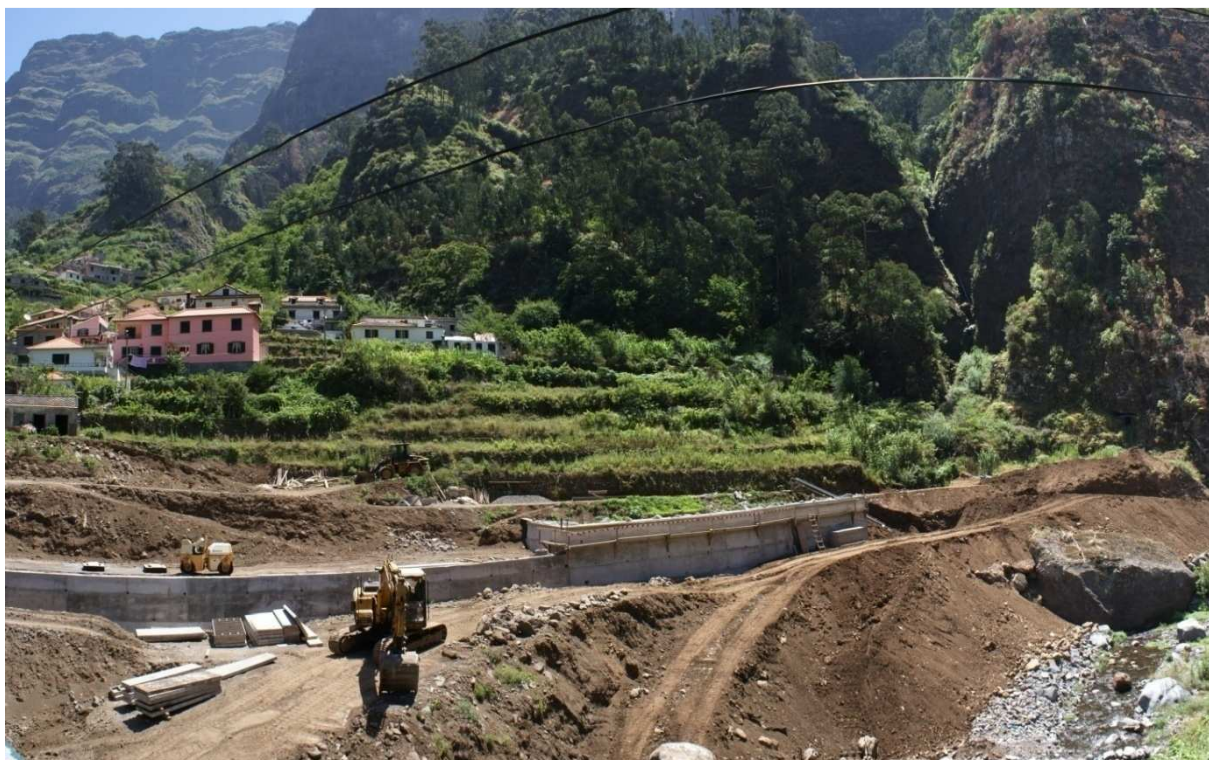
FIGURA VI.12 Terra Chã (Curral das Freiras). Construção de um estabelecimento de ensino, numa área de susceptibilidade elevada.
