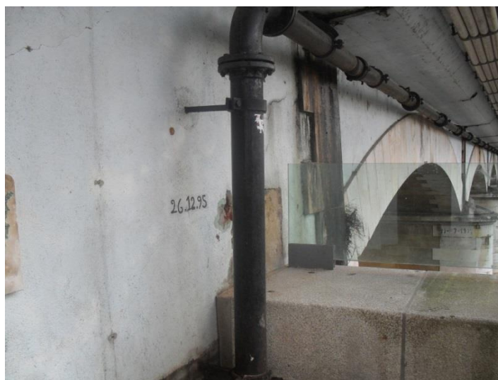
Fot. 2 – Limite máximo da cheia e inundação de 26 de Dezembro de 1995, gravadas na Ponte de Águeda.
