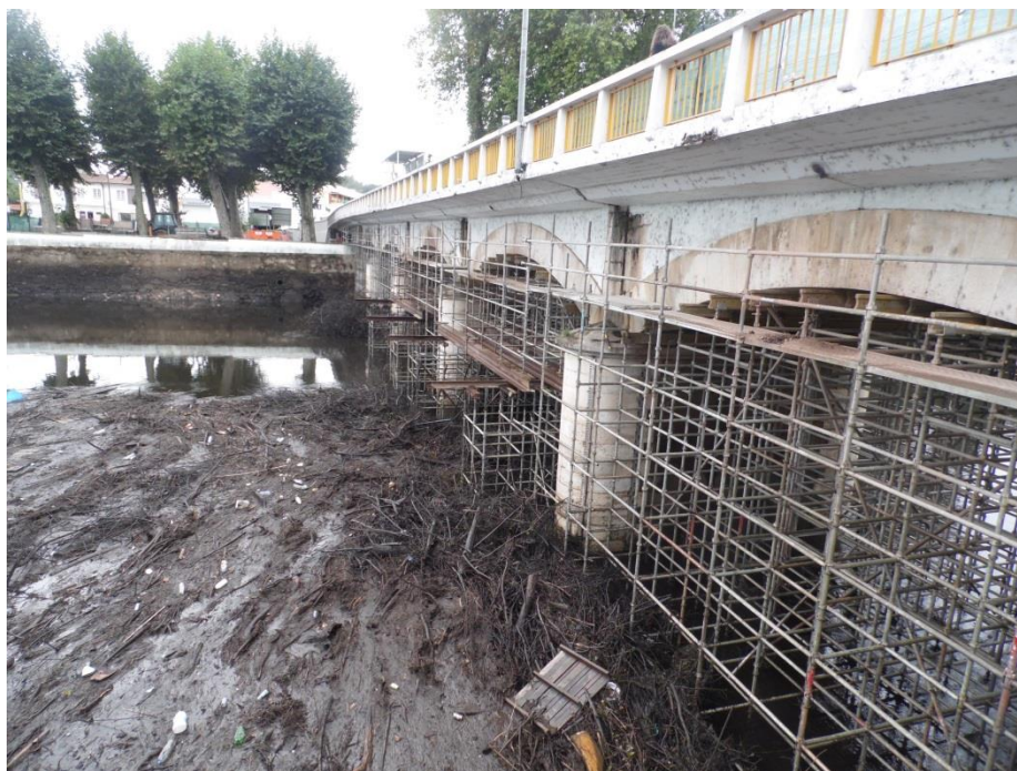
Fot. 10 – Pormenor da Ponte de Águeda com os andaimes e os detritos (2 de outubro de 2013).
