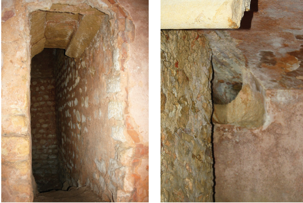
Fig. 81 e Fig. 82 Capeamento com tijoleira da entrada no aljubre dos clérigos.; canaleta de recolha de água.
