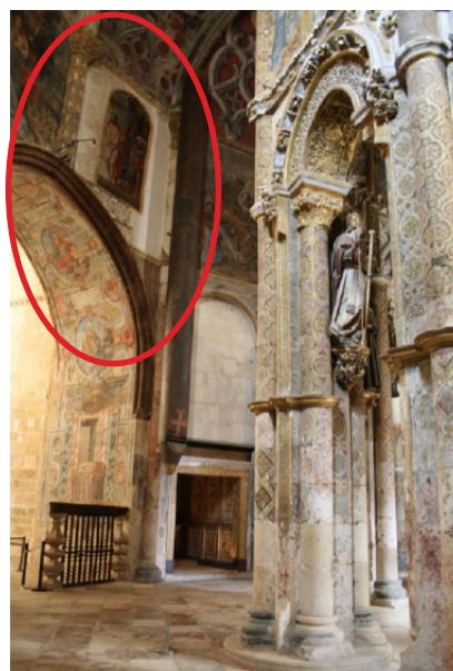
Fig. 32 Placas de estuque e vão entaipado.
