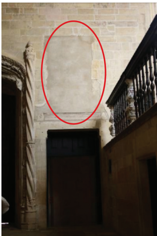
F. 354 Entaipamento da comunicação entre o coro alto e o coro dos cavaleiros.
