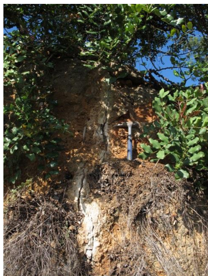
Fotografia 6.26 – Impregnação carbonatada fissural (Goncinha)
