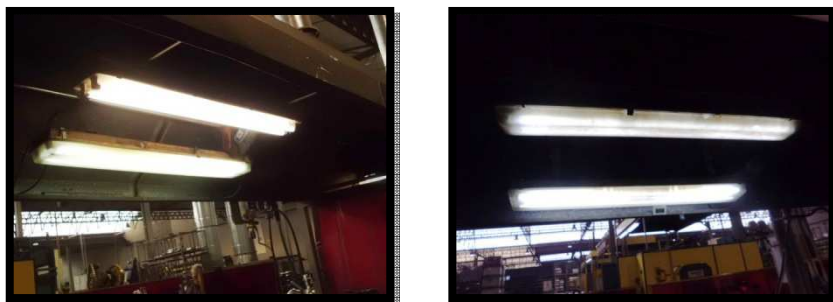
Figura 30 - Iluminação utilizada nas bancadas.
