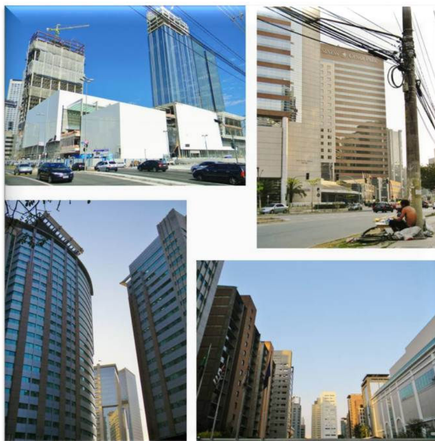
Figura 14. Da esquerda para a direita e de cima para baixo: Shopping JK em construção na Rua Funchal; Hotel Caesar Park na Rua Olímpíadas; Complexos Empresariais na Rua Fidêncio Ramos e Shopping Vila Olímpia na Rua São Tomé. Acervo do Autor (2011).
