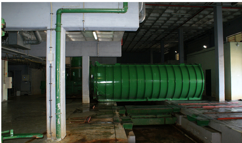
Fig. 125 - Interior da Central Sul, onde se pode ver um contentor hermético acoplado ao respetivo compactador.
