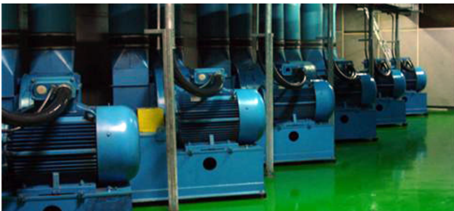
Fig. 122 - Turbo-extratores que permitem o transporte dos resíduos até às centrais.
