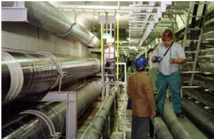
Fig. 98 - A galeria já após a instalação das diversas tubagens e cablagens afetas aos diversos sistemas infraestruturais.
