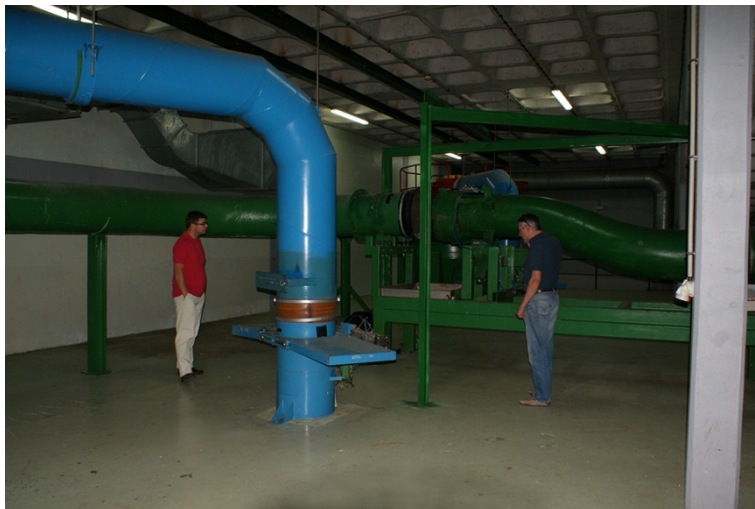
Tubagens de receção dos resíduos.
