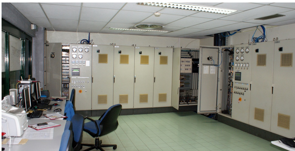
Fig. 126 - Sala de controlo geral na Central Sul.
