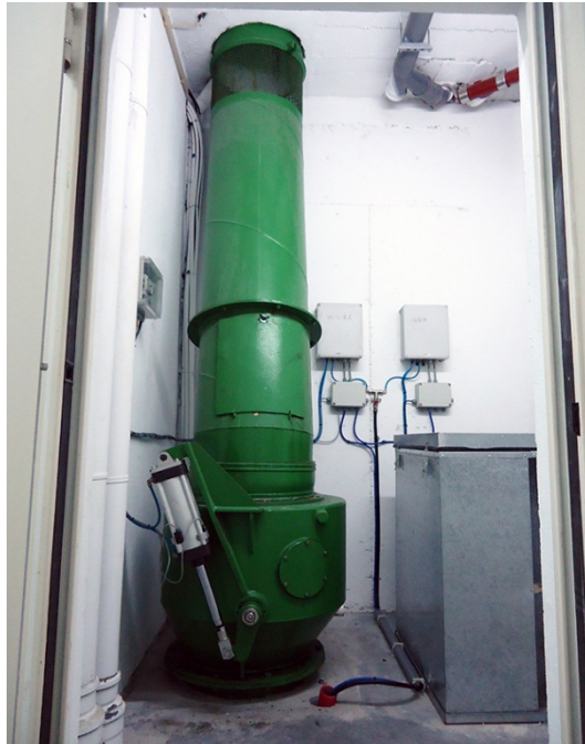
Fig. 114 - Válvula de descarga, integrada em compartimento específico na cave de um edifício de habitação.
