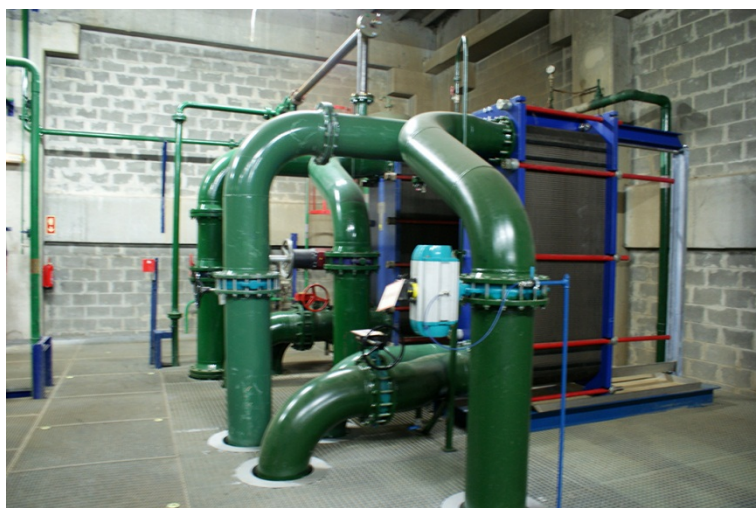
Permutadores de calor.
