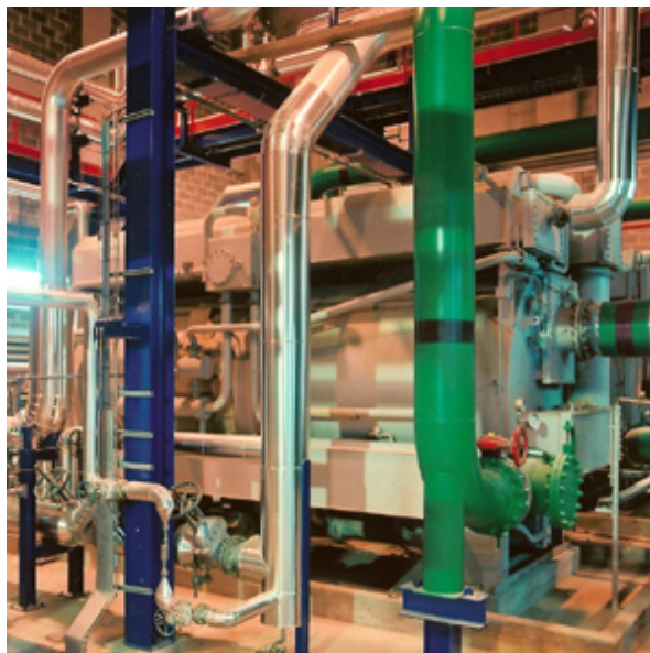
Fig. 140 - Chiller de absorção.
