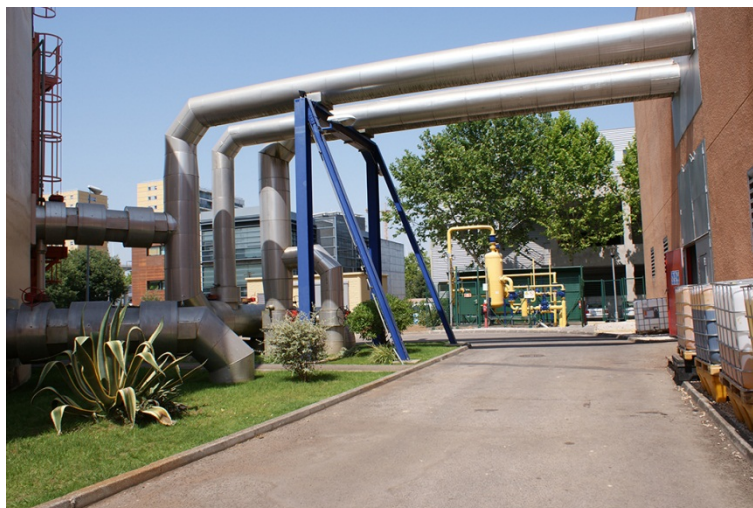
Tubagens de ligação entre os dois volumes.
