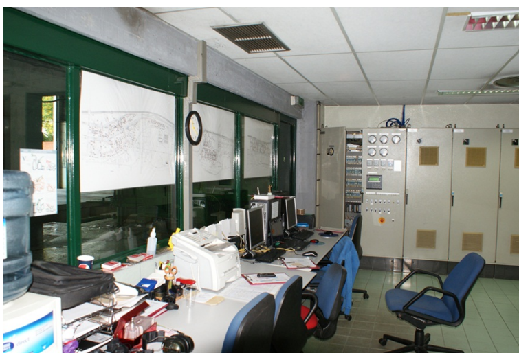
Sala de controlo geral do sistema.
