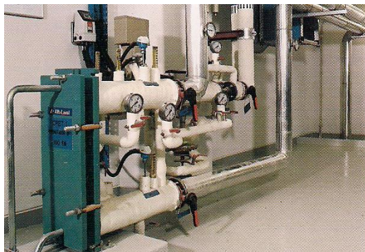
Fig. 146 - Equipamentos de regulação e controlo.
