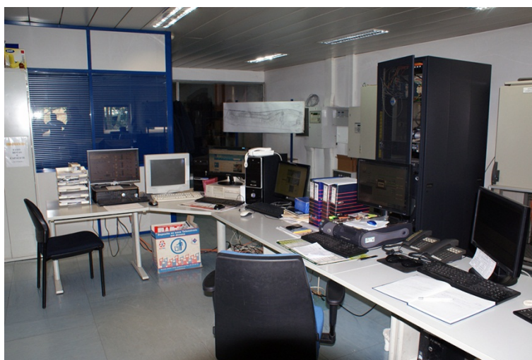
Sala de controlo e comando.
