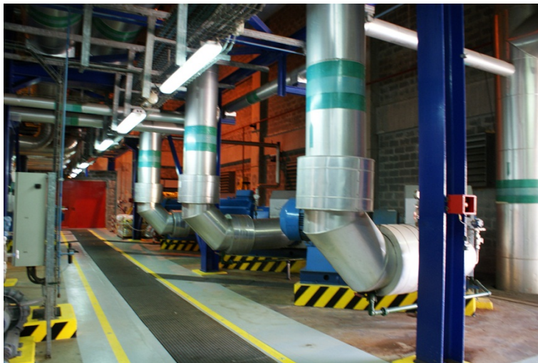
Módulos de bombagem.
