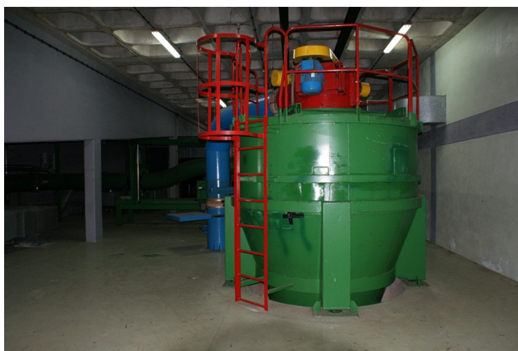
Piso superior onde se encontram instalados os ciclones.
