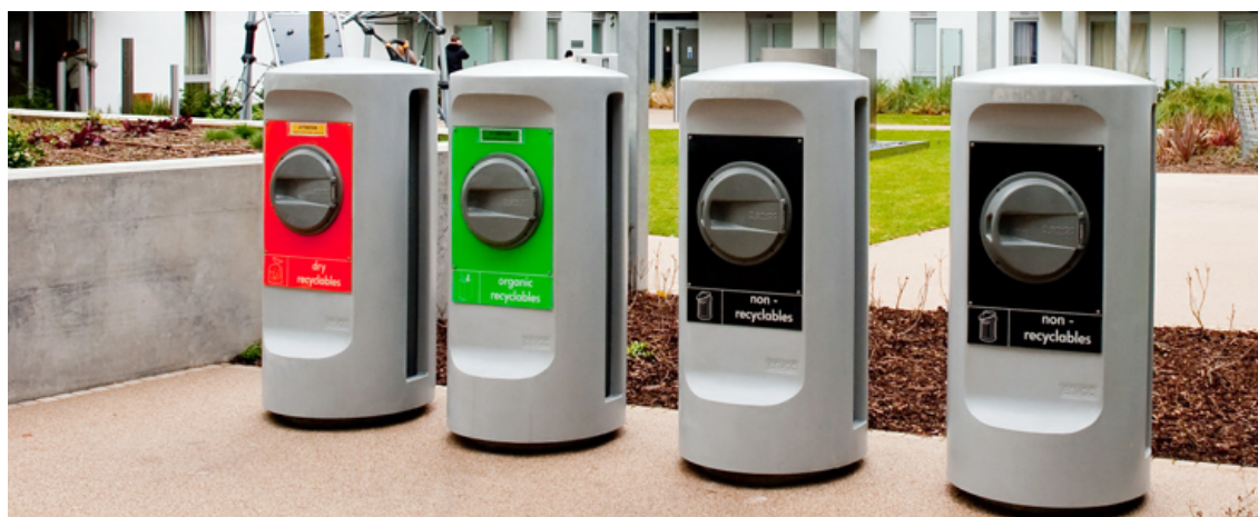
Fig. 105 - Exemplo de integração urbana das várias comportas de vazamento, Wembley City, Londres.
