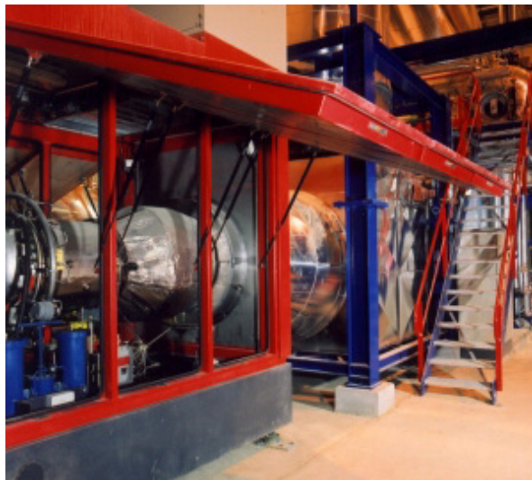
Fig. 139 - Turbina a gás e caldeira de recuperação.
