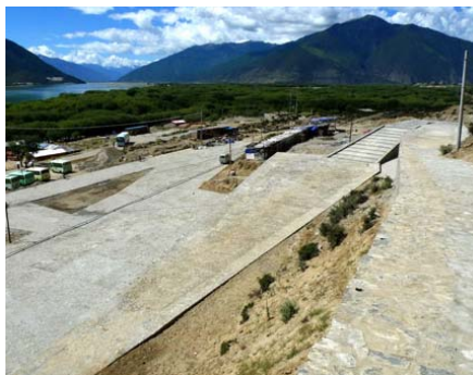
I 143 Centro de Visitantes de Niyang, Standardarchitecture + Embaixada, 2007. Visto de cima, a existência do edifício é anulada pelos percursos e declives do terreno.
