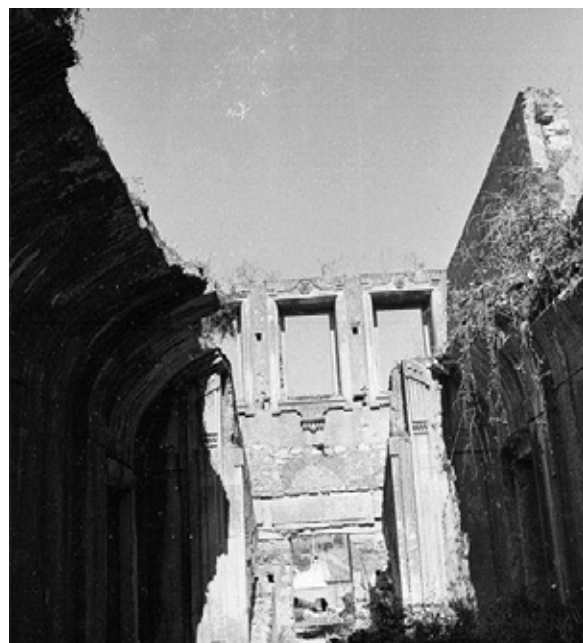
Figura 31: vestígios do arranque de abóbada em alvenaria de pedra (átrio que conduz à escada de aparato).
