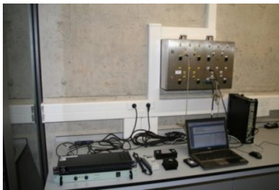
c) Equipamento de ensaio na sala de controlo.
