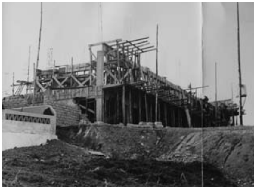
Estalagem D. Henrique, o Navegador, Baleeira (primeiro corpo de 20 quartos em construção) Fotografia, 1960 (imagem Arquivo Turismo de Portugal)
