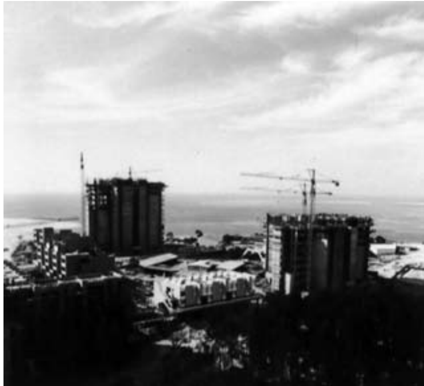
Ponta do Adoxe, Troia Torres T01 e T02 em construção Fotografia, c.1973 (imagem Arquivo Turismo de Portugal)
