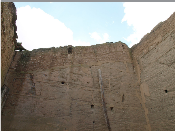
25. Juntas de cal verticais e diagonais - ruina no Alentejo, 2012
