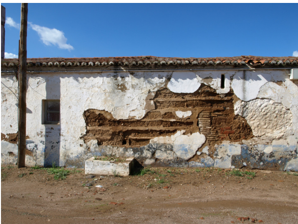
51. Concentração da erosão junto às camadas de cal
