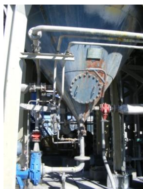
Figura 2.6- Silo de resíduos da Celbi.
