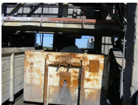
Figura 2.8- Contentor de armazenamento de dregs da Celbi.
