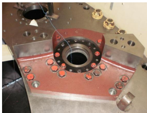
Figura 47. Chumaceiras superiores das pás directrizes e bases dos servomotores montadas e encavilhadas.
