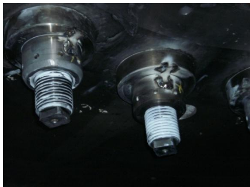
Figura 50. Acoplamento do veio da turbina com a roda, realizado com porcas devidamente travadas.
