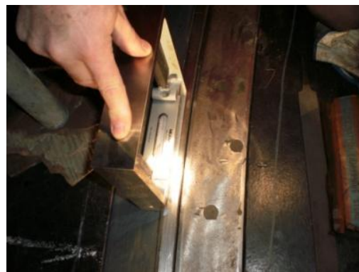
Figura 18. Controlo do nivelamento do obturador da válvula cilíndrica.
