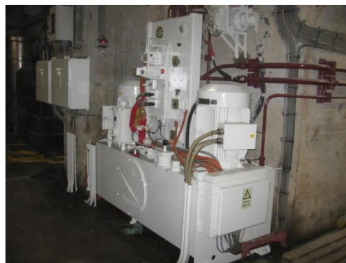
Figura 16. Unidade hidráulica recondicionada.
