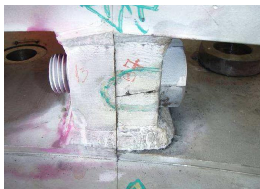
Figura 41. Fissura na zona de acoplamento das duas metades do anel suporte de patins da chumaceira combinada.
