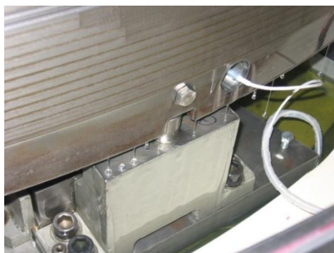
Figura 60. Sonda instalada num patim axial.
