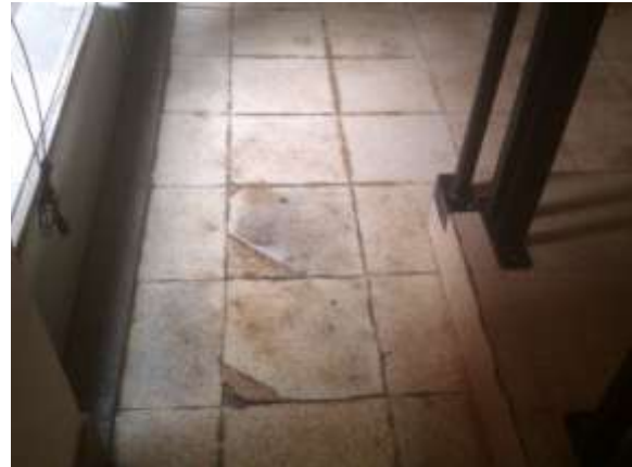
Figura C.14 – Pavimento degradado do Anfiteatro II.
