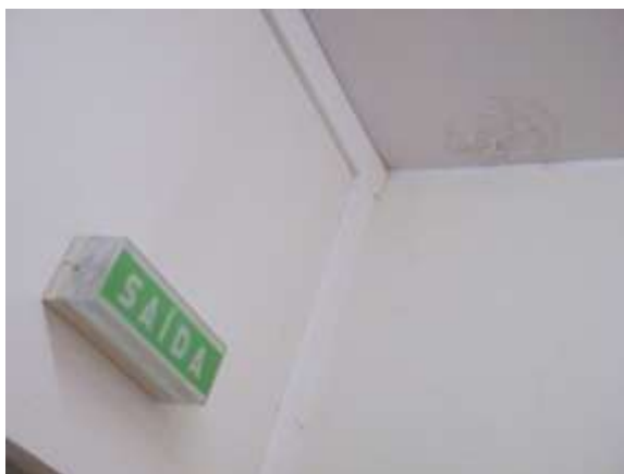
Figura C.1 – Presença de bolor à entrada da Sala de Computadores da Biblioteca.
