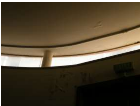
Figura C.3 – Presença de bolor no Anfiteatro I.
