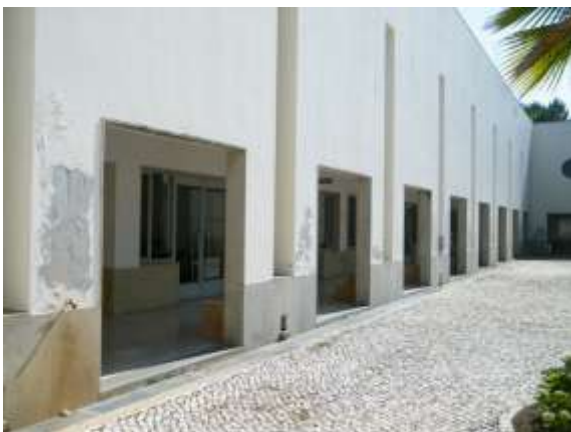
Figura C.7 – Infiltrações nas paredes exteriores.
