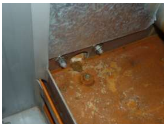
Figura C.10 – Sinais de ferrugem no tabuleiro dos condensados das UTAs da Biblioteca e do Auditório.
