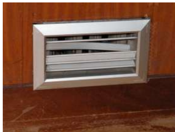
Figura C.6 – Grelha de extracção danificada na Sala de Computadores da Biblioteca.
