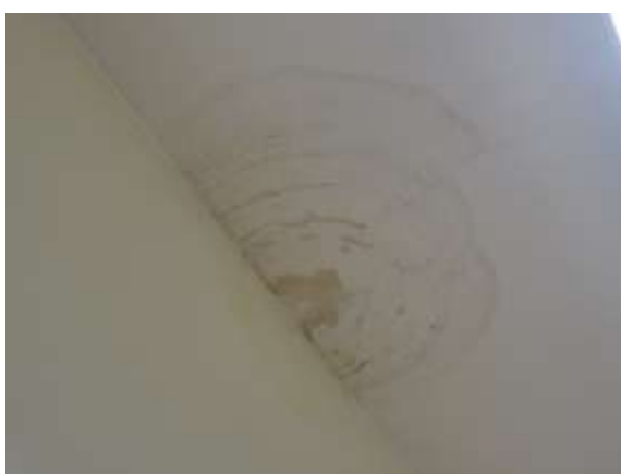
Figura C.12 – Registos de infiltrações no tecto à entrada da Sala de Reuniões a Este.
