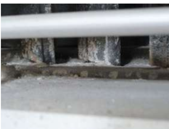
Figura C.11 – Partículas acumuladas nas grelhas de insuflação da Sala de Leitura da Biblioteca.
