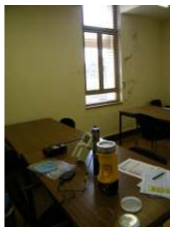
Figura C.4 – Infiltrações na Sala de Estudo da Biblioteca.
