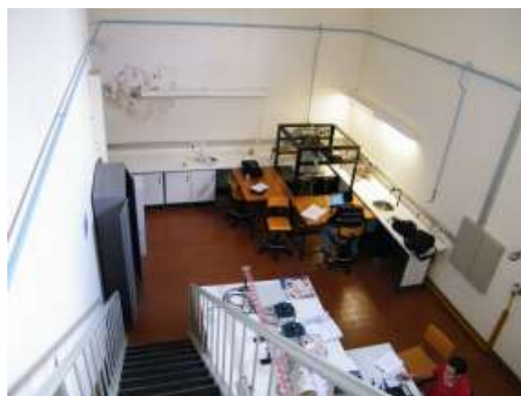
Figura C.2 – Presença de bolor no Lab. de Ecologia Industrial.
