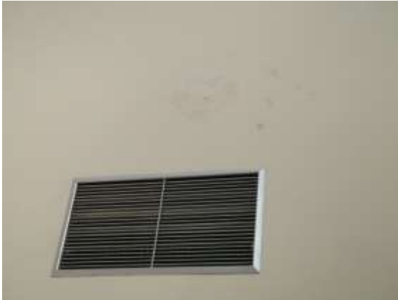
Figura C.13 – Infiltrações junto das grelhas de insuflação de ar novo na Sala de Leitura da Biblioteca.
