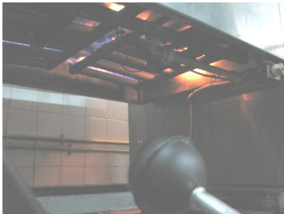
Fig. 5.13 - Sistema de aquecimento da frigideira basculante - Vista por baixo
