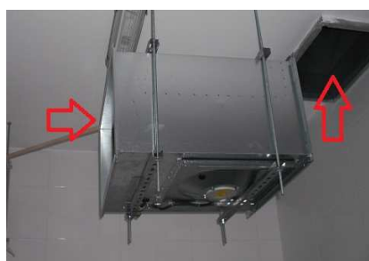
Figura 17. Aberturas temporárias não seladas.
