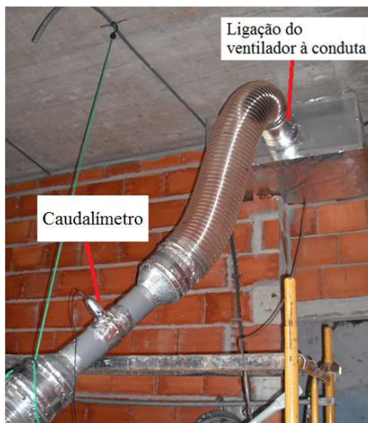
Figura 3. Ligação do ventilador à conduta através de uma conduta flexível e caudalímetro para medição de caudal.
