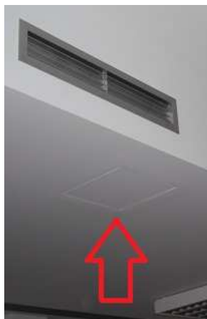
Figura 18. Porta de acesso junto a ventilo-convector.
