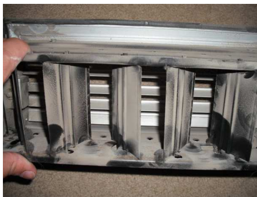
Figura 30. Ausência de limpeza nas grelhas de recirculação.
