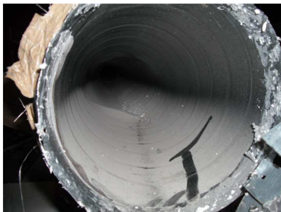
Figura 21. Conduto de insuflação completamente empoeirada.
