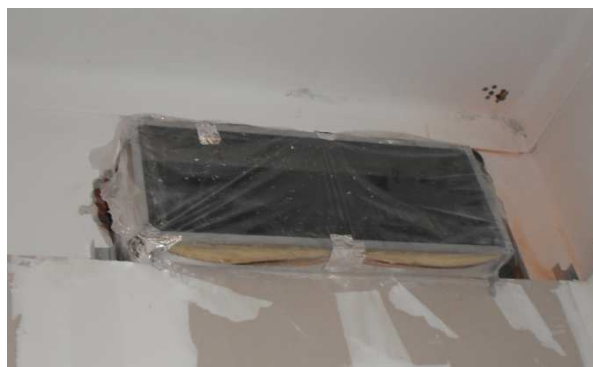
Figura 20. Abertura temporária selada.
