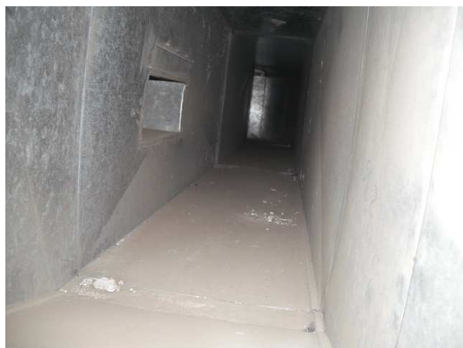
Figura 29. Ausência de limpeza na conduta de recirculação.
