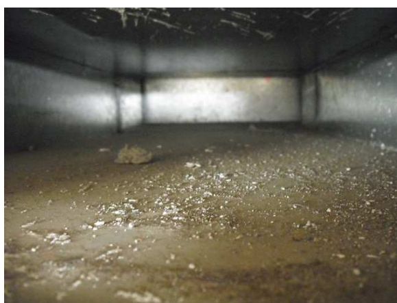
Figura 28. Ausência de limpeza na conduta de insuflação.
