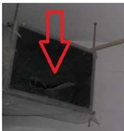
Figura 16. Abertura temporária selada de modo incorreto.
