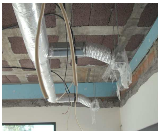
Figura 26. Tamponamento dos plenos de modo incorreto.
