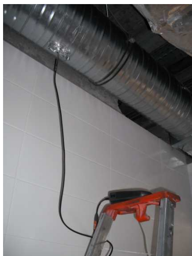
Figura 2. Ligação da tomada de pressão à conduta.
