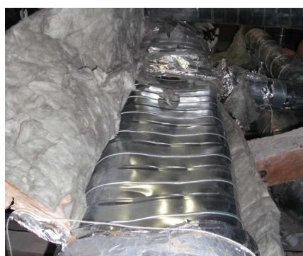
Figura 23. Troço de conduta esmagado.
