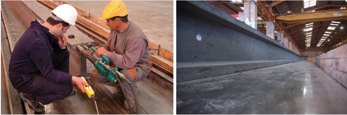
Figura 4.14: Aplicação de pós-esforço nos cabos superiores e viga após transferência do pré-esforço
