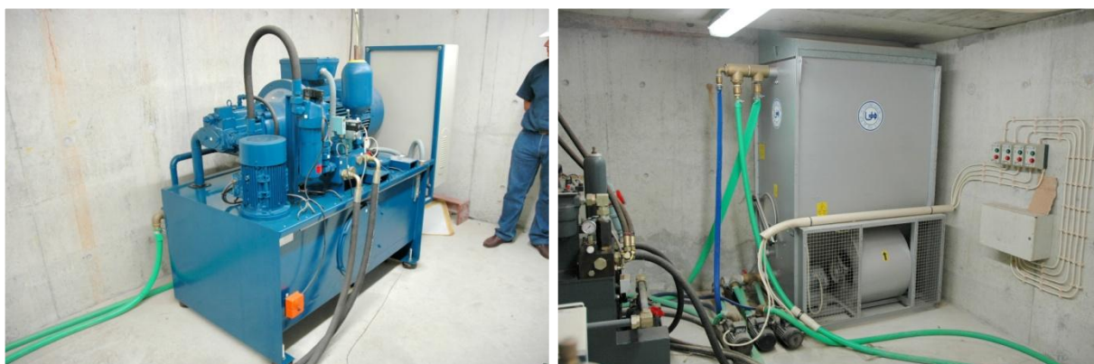
Figura 4.26: Grupo hidráulico e permutador ar/água de refrigeração
