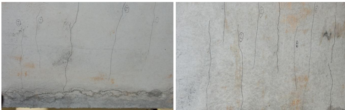
Figura 4.35: Padrão de fissuração na face inferior da viga para um deslocamento do actuador de 150 mm
