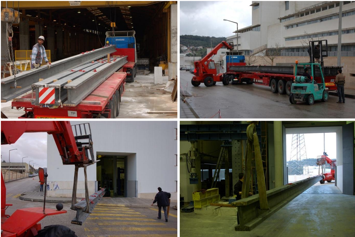
Figura 4.15: Carga, descarga e colocação das vigas nos Laboratórios do DEC-FCTUC (Pólo II)
