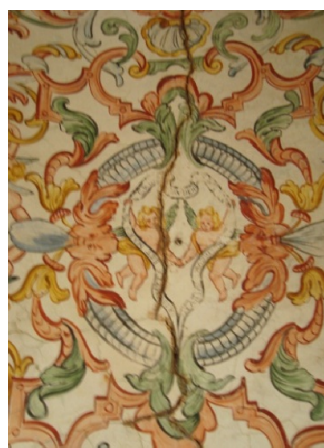
Fig.21 - Fissura ao longo eixo central da nave.
