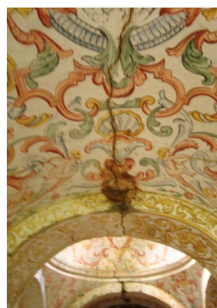
Fig.22 - Prolongamento da fissura para o cruceiro.
