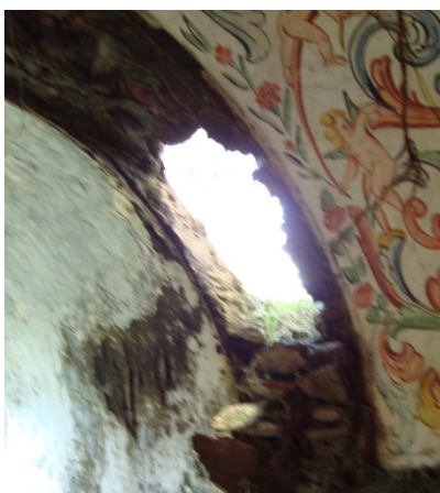
Fig.20 - Danos no arco de entrada.
