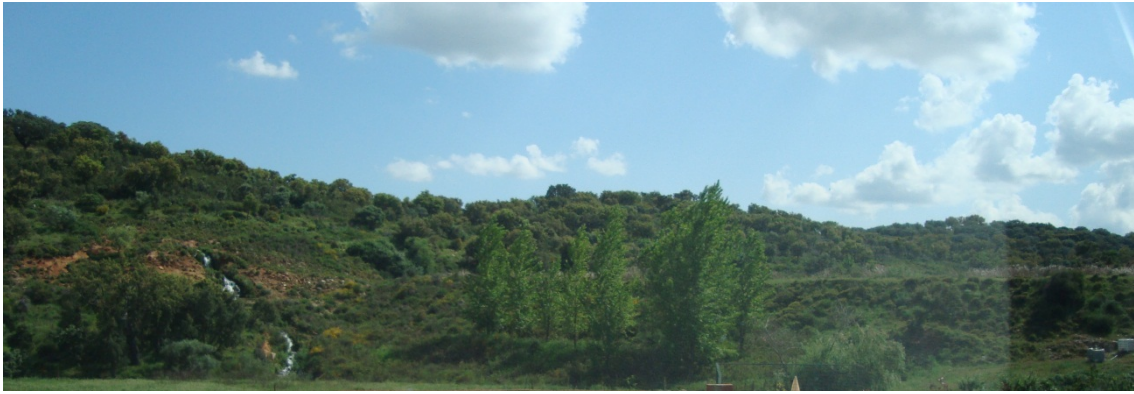
Fig. 67 – Imagem do muro da Barragem e uma pequena cascata que dá para o ribeiro do beíçudo.
