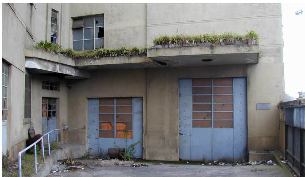
Fig 171. Entrada para o armazém onde são visíveis sinais evidentes de abandono e degradação.
