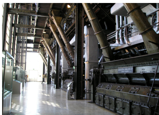
Fig 136. Museu da Electricidade - Zona das caldeiras.
