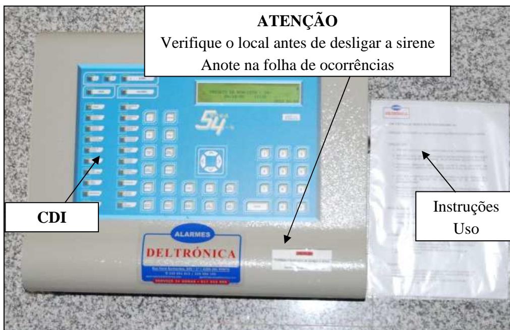
Figura 4.15 – CDI na Entrada do Edifício, com as Instruções de Uso.
