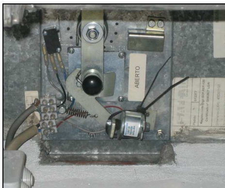
Figura 1.11 – Registo corta-fogo desactivado com abraçadeira de plástico
