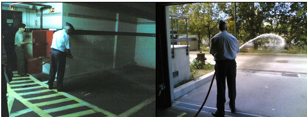
Figura 4.17 – Teste às Bocas-de-incêndio do Parque de Estacionamento
