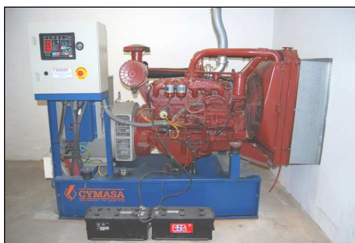
Figura 4.12 – Grupo Gerador de Emergência, depois de reparado. Foto: Mário Rui.
