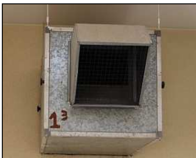
Figura 4.7 – Ventilador de Pressurização do Interior de uma das Caixas de Escada. Foto: Mário Rui.
