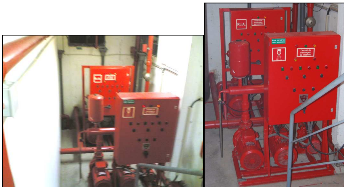
Figura 4.5 – Central de Bombagem e Grupos de Bombagem de Incêndio da RIA e Sprinklers, em detalhe. Foto: Mário Rui
