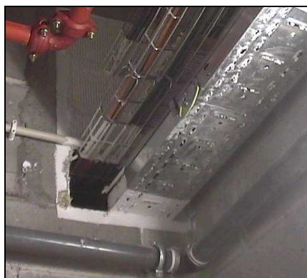
Figura 1.12 – Selagem corta-fogo violada
