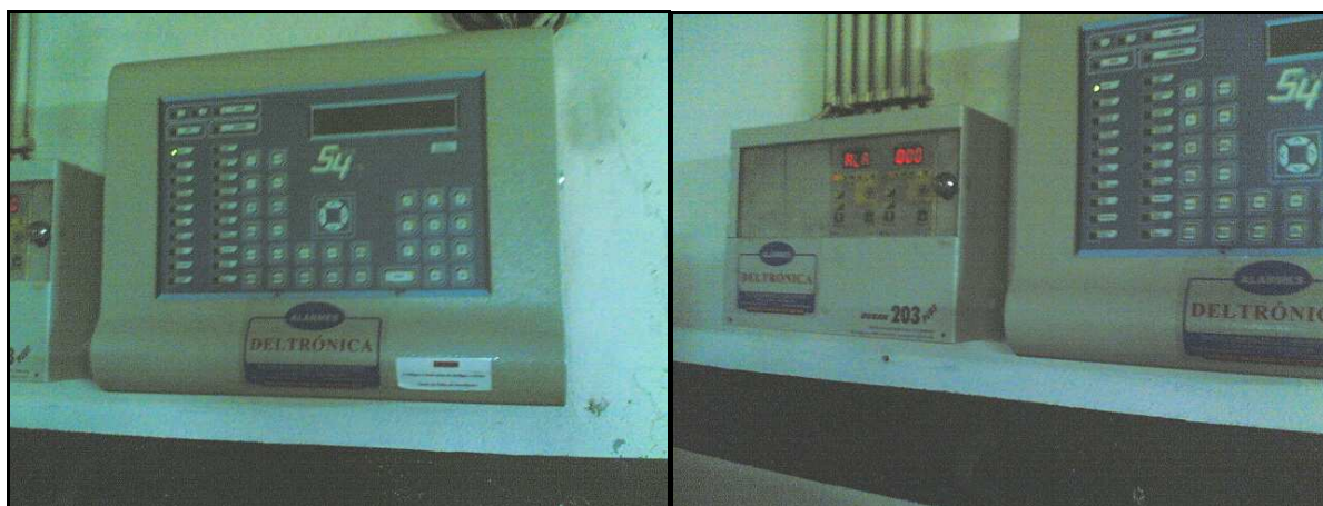
Figura 4.2 – CDI e Central de Detecção de Monóxido de Carbono (CDCO), no Estacionamento.
