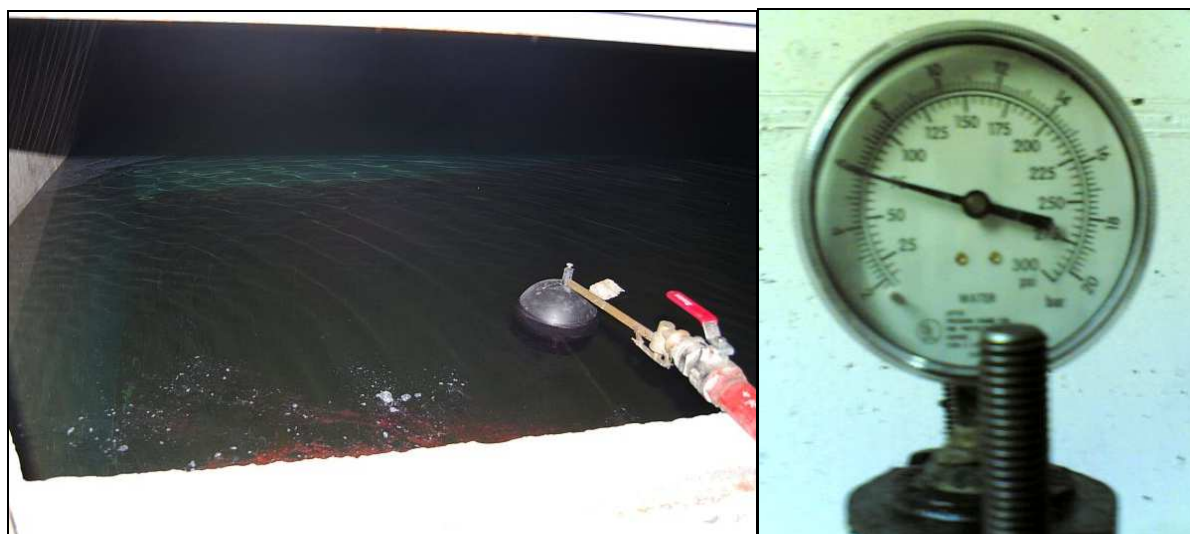
Figura 4.14 – Esquerda: Cisterna com Reserva de Água para Incêndio. Direita: Manómetro indicando a Pressão na Rede de Incêndio de 6 bar. Fotos: Mário Rui.
