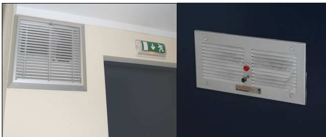
Figura 4.10 – Registo Corta-fogo e Grelha de Transferência numa Câmara Corta-fogo. Fotos: Mário Rui
