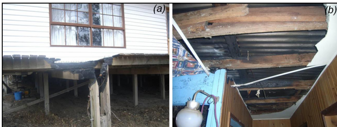
Figura 2.27 – Danos provocados pelo fogo no dia 7-Fev-2009: (a) Varanda em Marysville; (b) Telhado em Kinglake. (Fonte: CRC)
