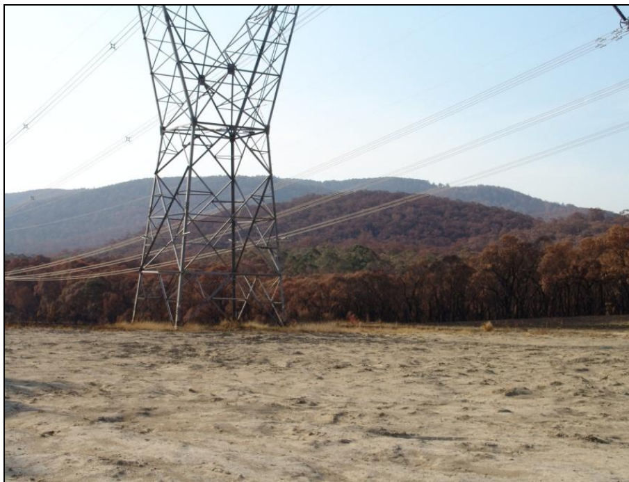
Figura 2.11 – Cabo de alta tensão caído perto de Kilmore. (Fonte: CRC)
