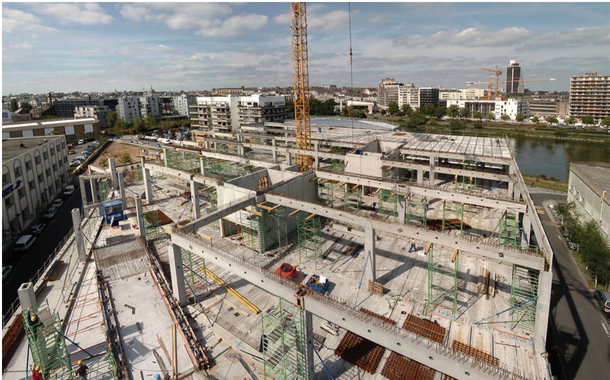
Fig.71 Fotografia da escola em construção onde se poderá ver, com mais pormenor, o tipo e o modo de assemblagem da estrutura principal das peças prefabricadas de betão
