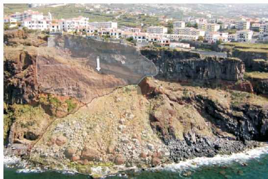
Fot. 4 - Desabamento num talude costeiro. Adaptado de RODRIGUES (2005)
