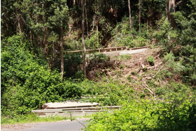
Figura 110- Falta de limpeza e deposição sobre um tributário da ribeira do Campanário.
