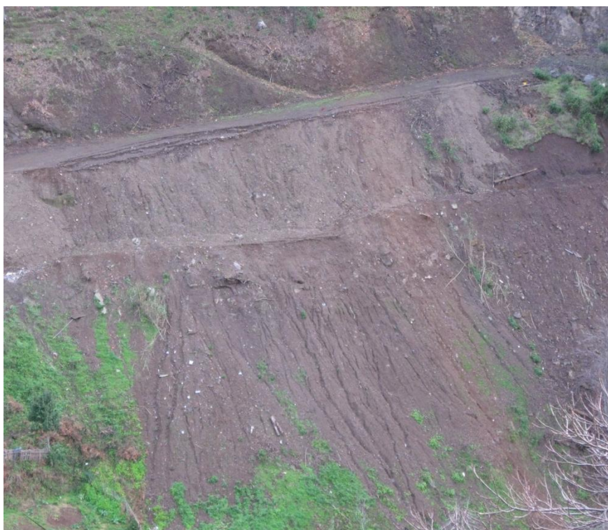
Figura 93 – Ravinamentos em aterro na vertente Este do vale da Ribeira do Espigão.
