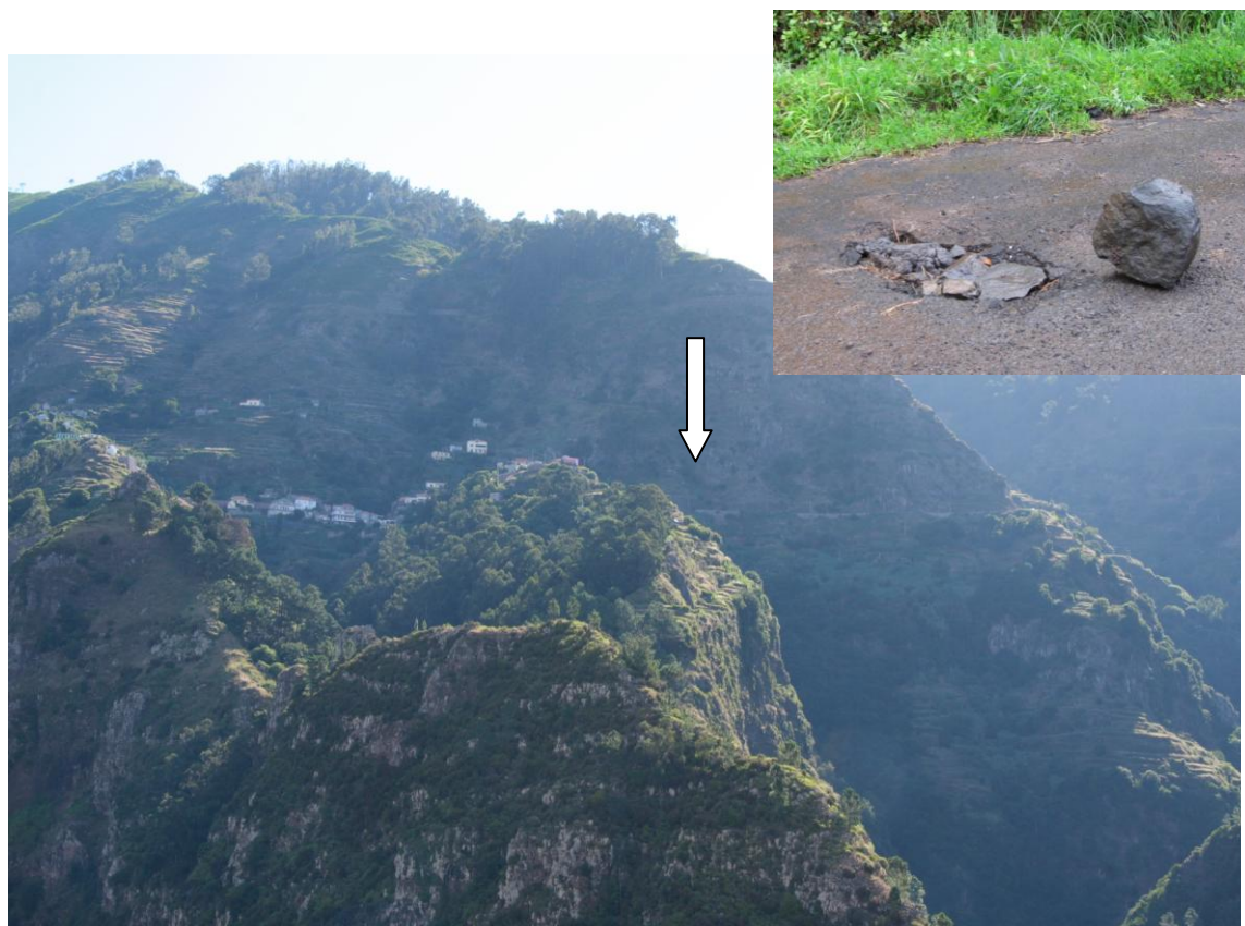
Figura 58 - Vista do Lugar do Espigão no Lado Este do Vale da Ribeira Brava, Canto Superior: Pormenor de Uma Queda de Blocos e Danos no Pavimento.
