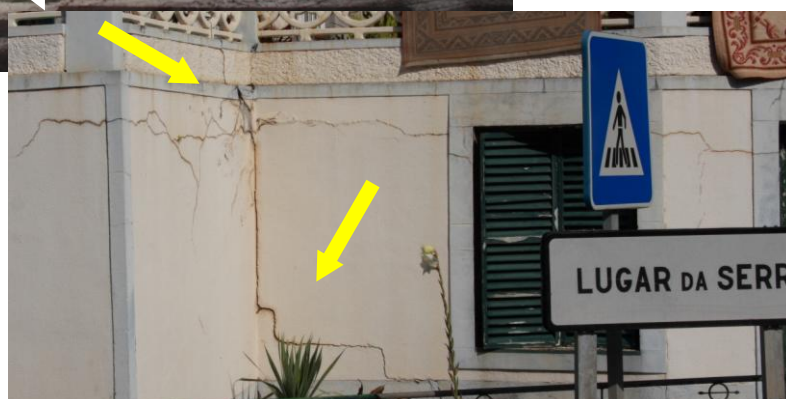
Figura 69 – Pormenor das fracturas
