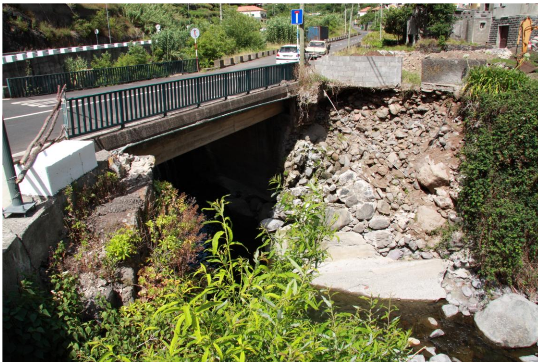
Figura 109 – Ponte da Serra de Água, com sinais claros de ruptura.
