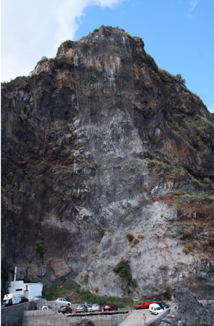
Figura 50 - Escarpa do Cais da Ribeira Brava onde a queda de blocos é uma constante, onde podemos observar a cobertura parcial da vertente com “rede” de protecção.
