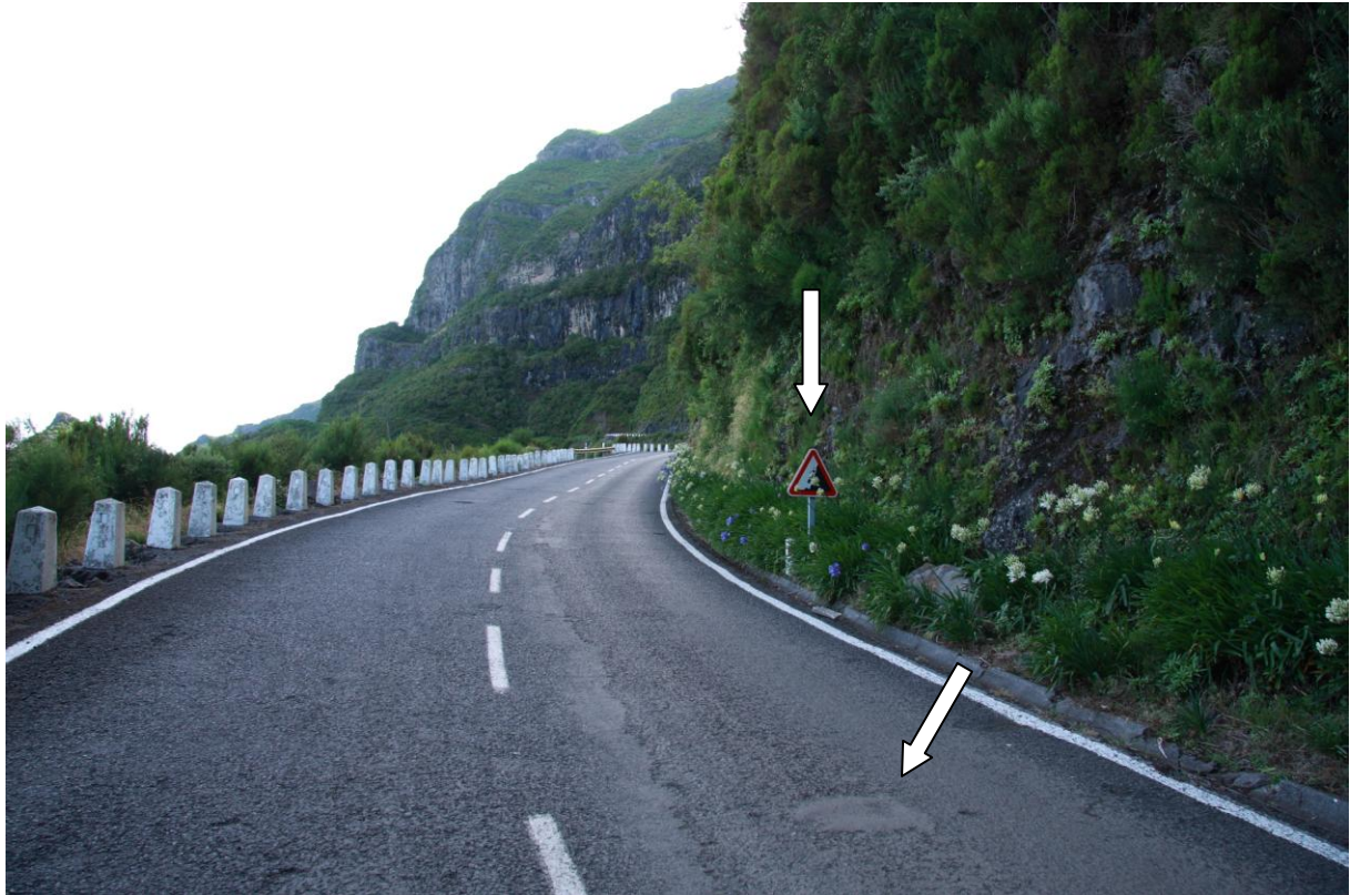
Figura 59 – Estrada que liga a Encumeada ao Paúl da Serra, área de elevado perigo de queda de blocos.
