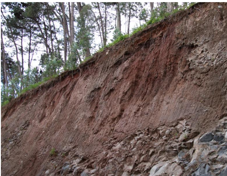
Figura 92 - Ravinamentos na encosta sobranceira à estrada no sítio da Adega, Campanário.
