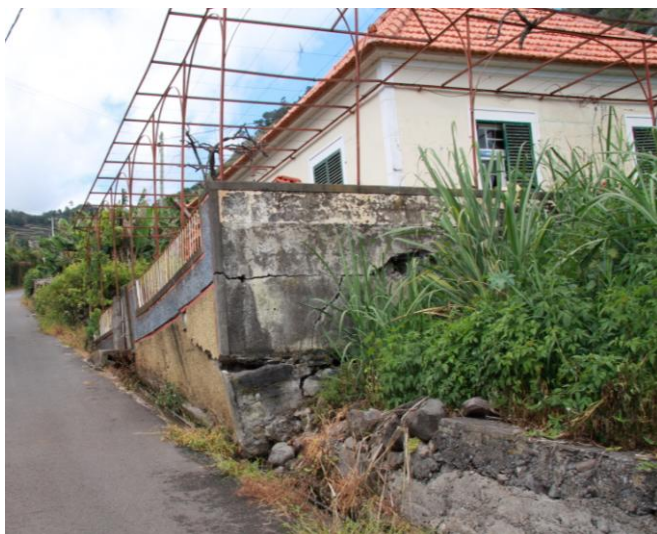
Figura 71 – Fenda estrutural numa casa na Tabua
