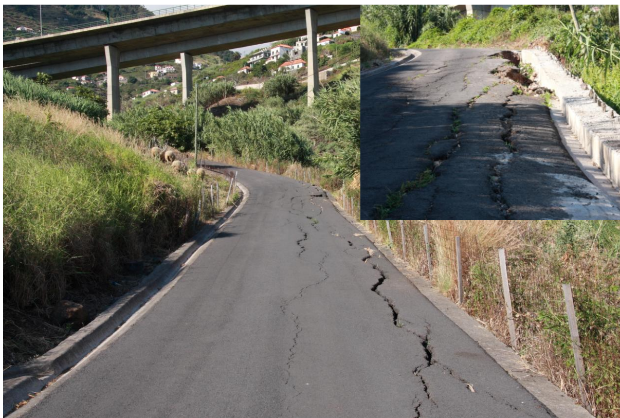
Figura 87 – Fendas na estrada de ligação a capela da Glória, uma área de susceptibilidade a movimentos de vertente.
