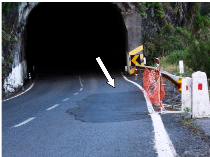
Figura 60 – Pormenor de um deslizamento que está a provocar o abatimento da estrada, apresentando algumas fendas.
