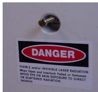
Figura 8 Interlock de protecção da cobertura do laser. (27)
