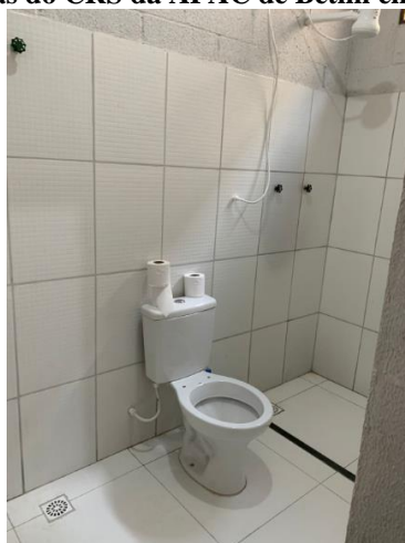
Figura 102 – Instalações sanitárias do CRS da APAC de Betim em junho/2022
