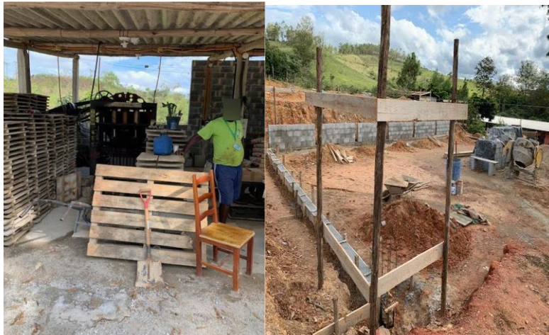
Figura 35 - Fábrica de artefatos de concreto
