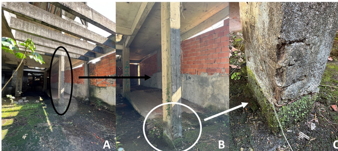
Figura 26 - Pilar P14: (A, B) referência; (C) pormenor das patologias.
