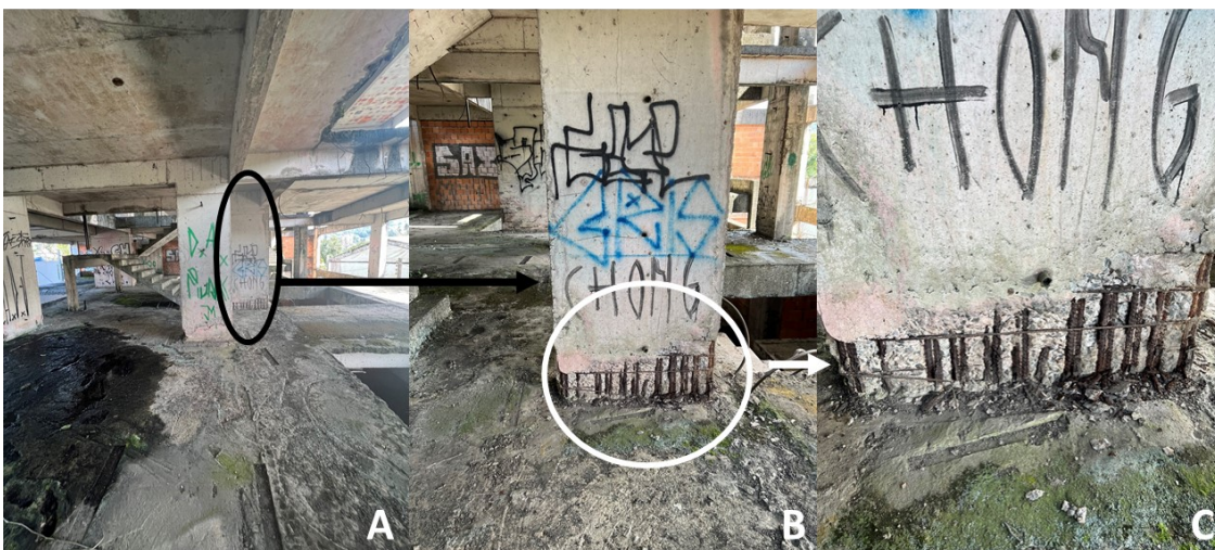
Figura 30 - Pilar P49: (A e B) localização; (C) pormenor do destacamento (Fonte: Autora)
