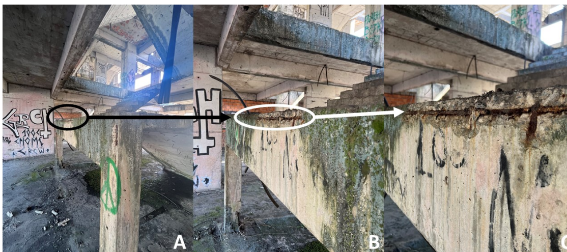
Figura 31 - Viga V51-32: (A, B) localização; (C) pormenor do destacamento.
