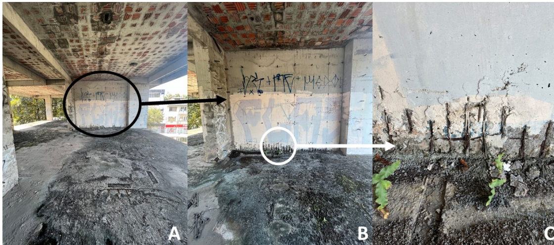
Figura 33 - Destacamento de betão: (A e B) localização; (C) pormenor.
