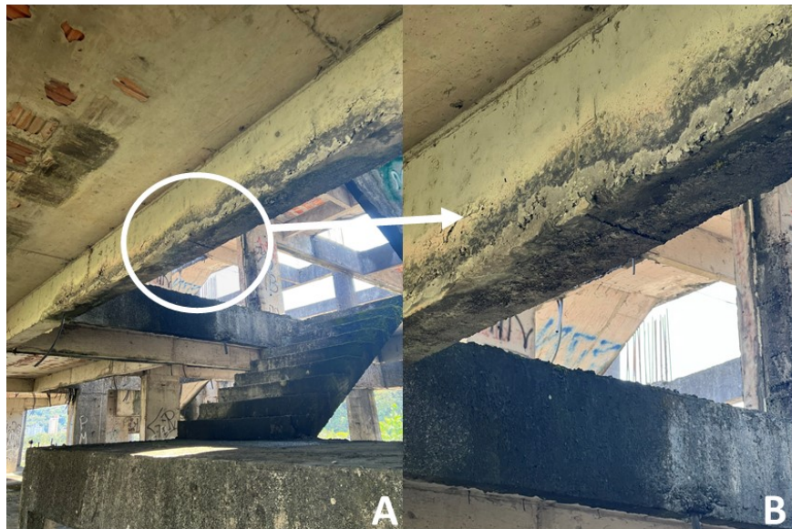
Figura 47 - (A) Localização da patologia (escada entre P51 e P32); (B) detalhe.
