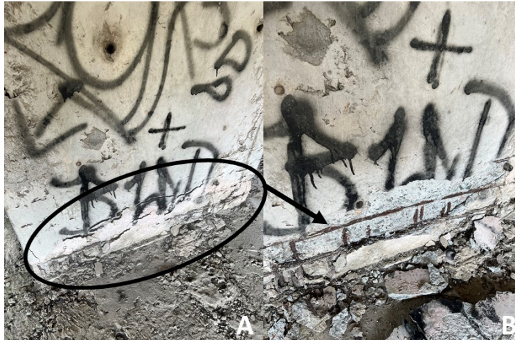
Figura 35 – Pilar P34 com destacamento de betão
