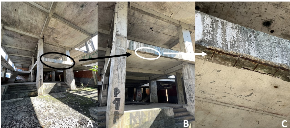
Figura 28 - Viga V26-35: (A, B) referência; (C) pormenor das patologias.
