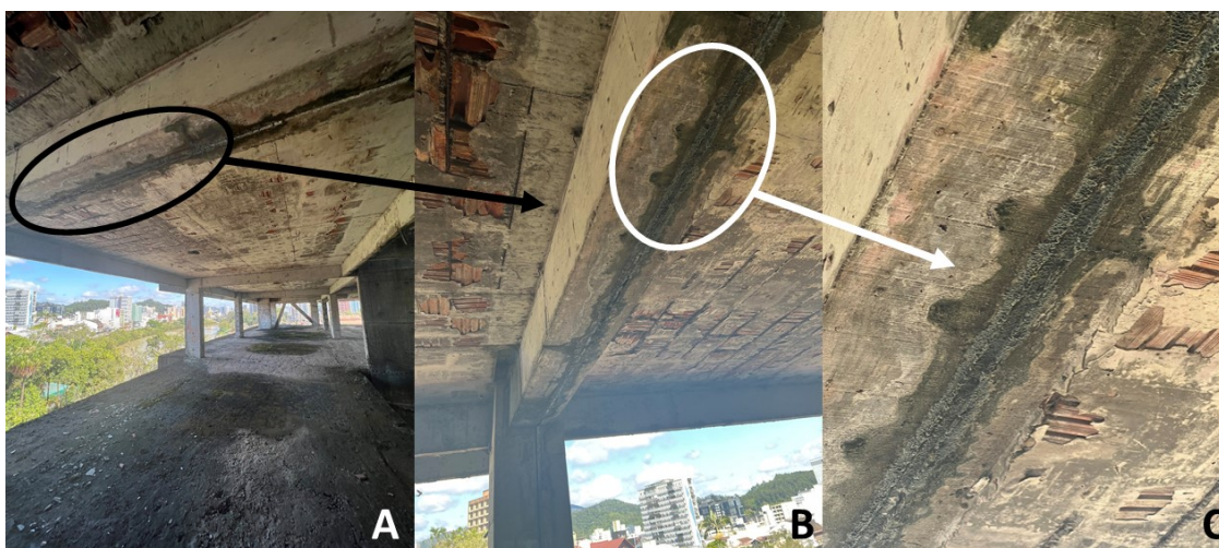
Figura 39 - “Viga” dividida pela junta J1: (A e B) localização; (C) patologia.
