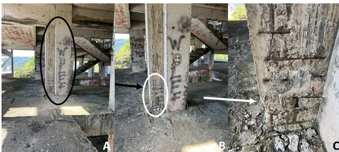
Figura 37 - Pilares P23 e P22: (A) localização; (B e C) danos observados.
