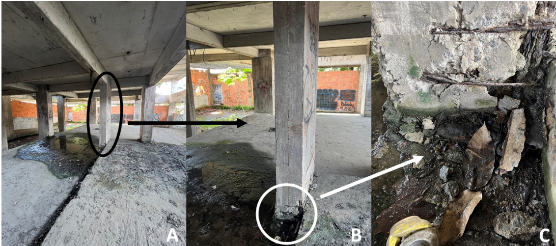
Figura 27- Pilar P25b e poça: (A, B) referência; (C) pormenor das patologias.
