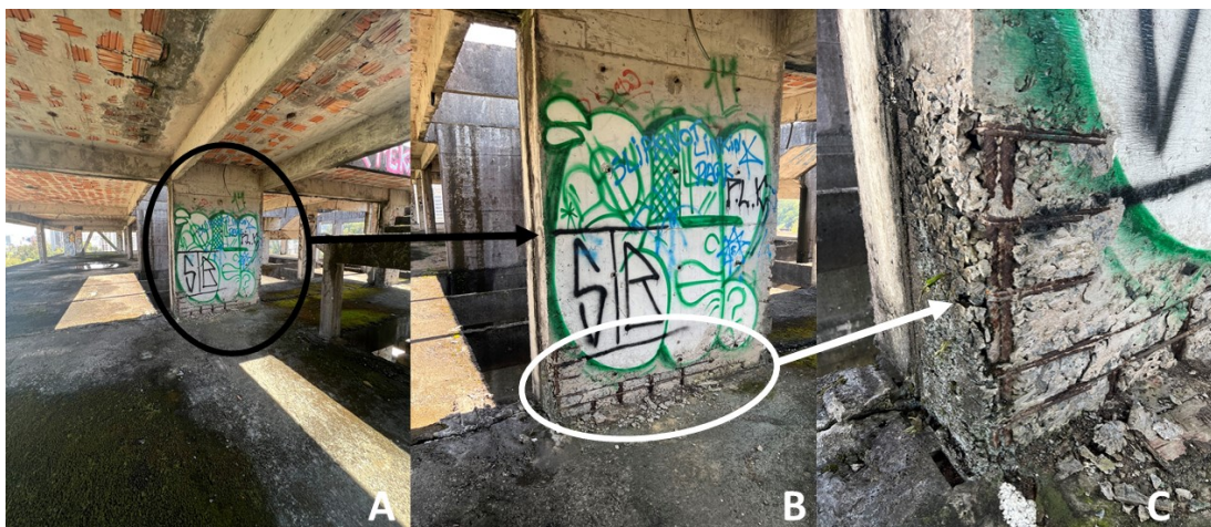
Figura 48 - (A e B) Localização da patologia (P32); (C) detalhe.
