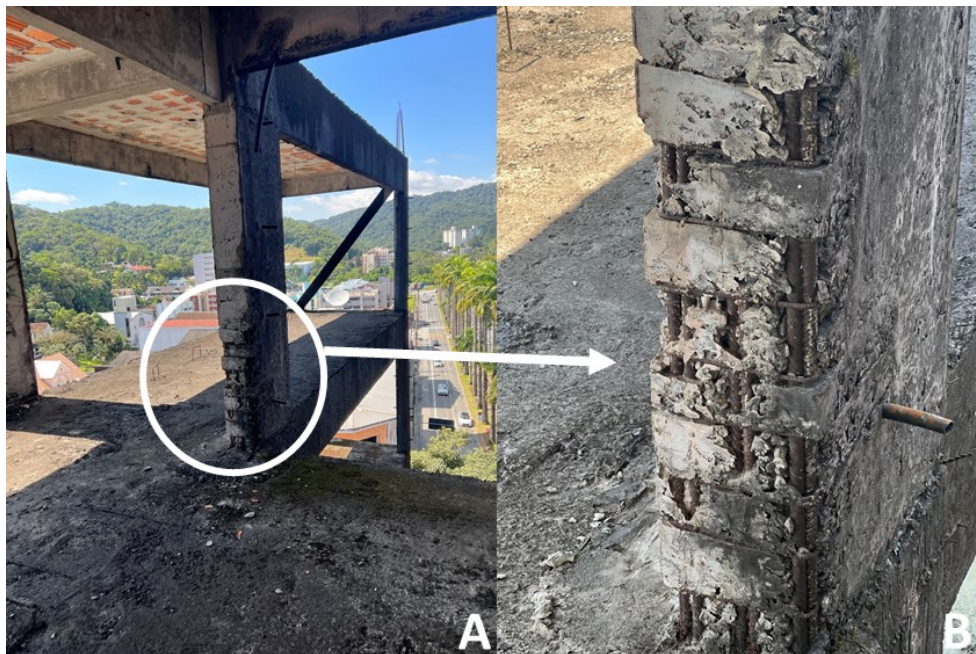
Figura 49 - (A) Localização da patologia (P12); (B) detalhe.
