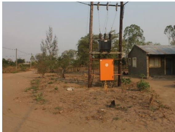
Figura 44 - Rede eléctrica no bairro Josina Machel (2019)
