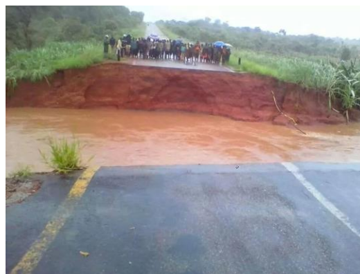
Figura 46 - Característica do pavimento destruído pelas águas (2008)
