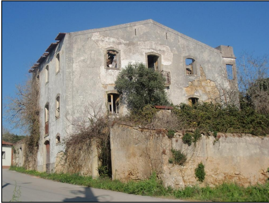
Foto 3.3 - Casa em ruínas, constituindo risco para a circulação de pessoas e veículos.
