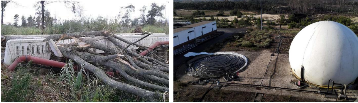
Fotografia 15 - Danos num troço de uma conduta em Cochadas e na ETAR do Coimbrão no Leslie.
