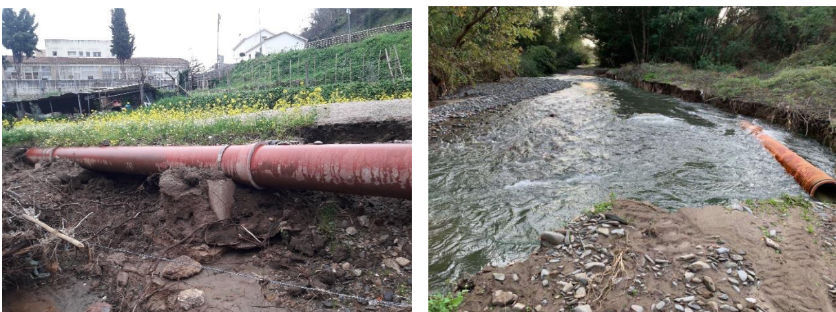
Fotografia 11 - Emissário de Miranda do Corvo e emissário na Lousã na ocorrência do Elsa respetivamente
