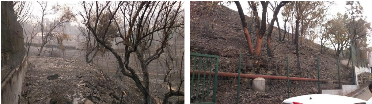
Fotografia 19 - Impacto dos incêndios de 2017 na ETAR de Vila Nova do Ceira
