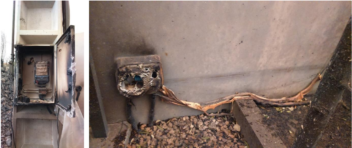
Fotografia 18 - Impacto dos incêndios de 2017 na ETAR de Serpins
