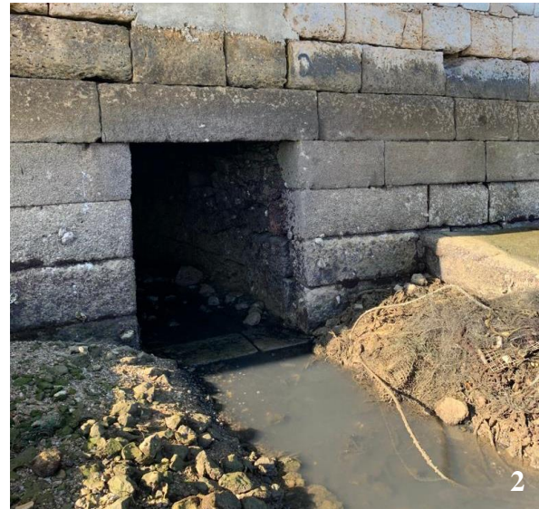
Fotografia 3: Ponto de descarga da bacia de drenagem “Mercados”.
