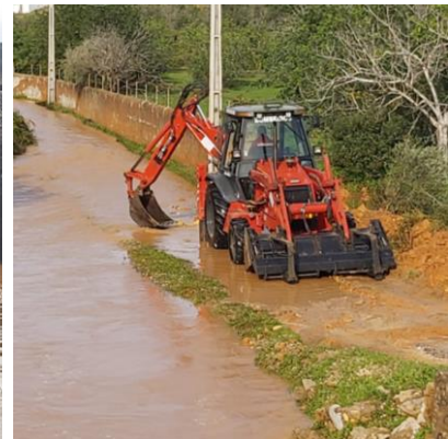
Fotografia 21: Operação de limpeza e desobstrução de caminhos rurais com recurso a máquina retroescavadora. Fonte: GBMPC.
