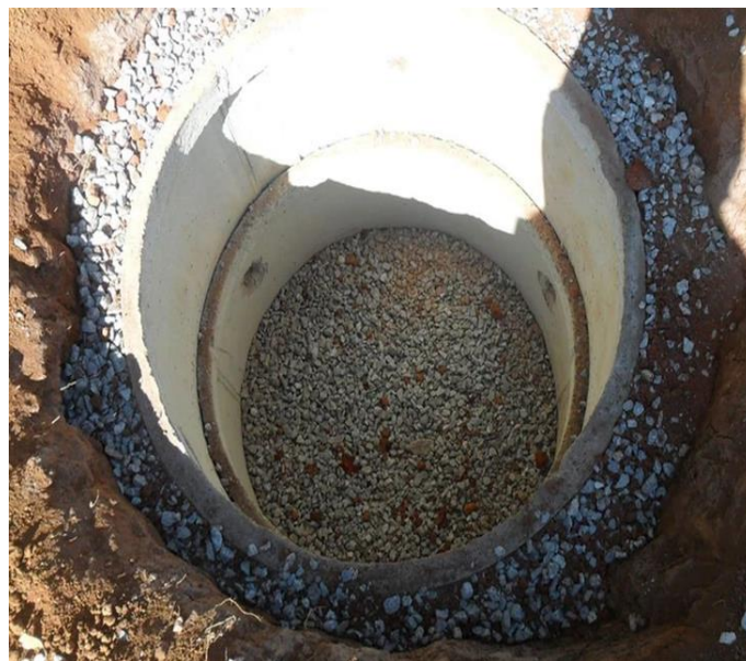
Fotografia 31: Exemplo de um poço de infiltração. Fonte: https://www.bauenconstrutorasp.com.br/
