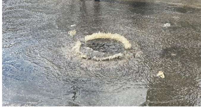
Fotografia 1: Exemplo da falta de capacidade do sistema de drenagem em situação de pluviosidade intensa. Fonte: Própria
