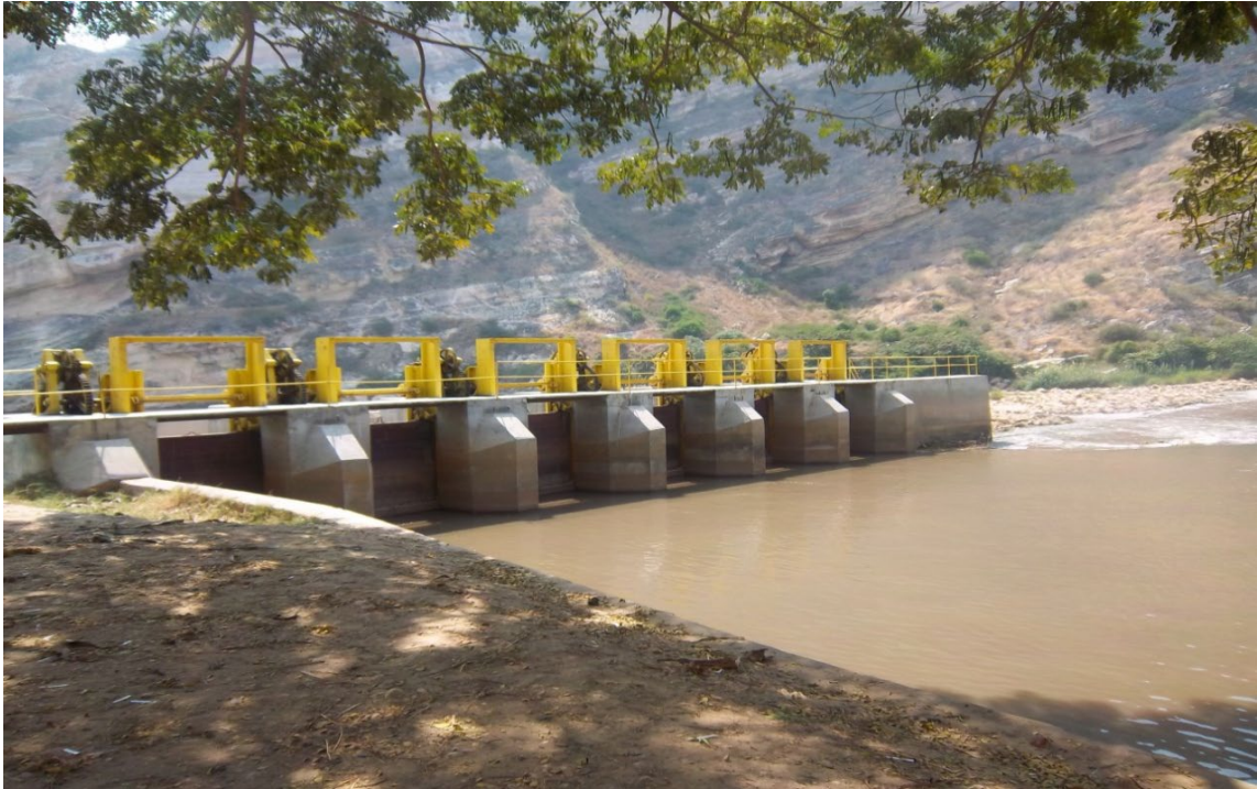
Figura 4.3 Estrutura de represamento da água no rio Catumbela a 5 km da ponte em estado degradado.
