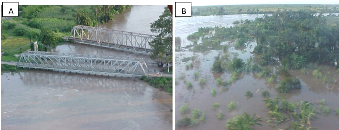
Figura- 4.7- Água batendo na tabuleta da ponte ferroviária e rodoviária sobre o rio Catumbela (A) e inundação do perímetro agrícola (B). Fotos das cheias de 2002.
