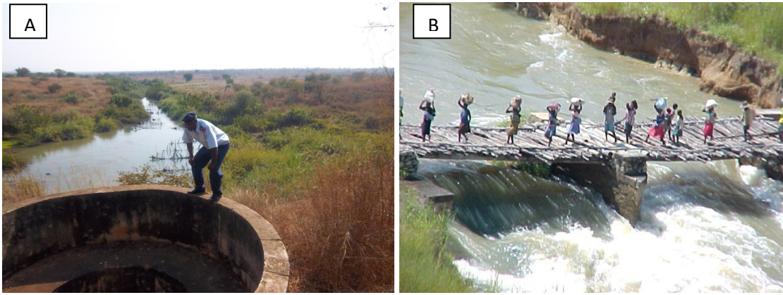
Figura 4.10- Estado actual das Comportas da Barragem do Ndungo (A) e travessia de pessoas na ponte alternativa sobre o rio Cubal da Hanha (B) cheias de 2002.
