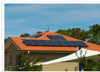
Sistema solar fotovoltaico
