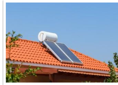
Sistema solar térmico
