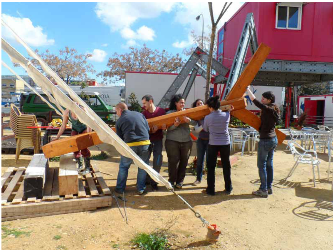
Fig. 18 | Autoconstrução de estrutura do espaço cultural La Carpa, Sevilha, assessorada pelo atelier Recetas Urbanas
