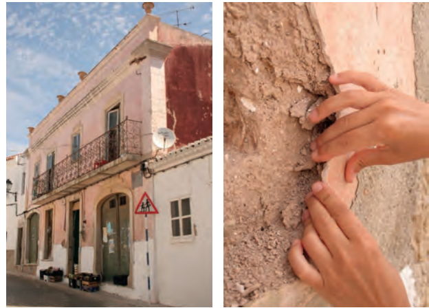
FIGURA 4 Caracterização de revestimentos por amostras retiradas de edifício na Aldeia de Paderne (Câmara Municipal de Albufeira, Filipe Palma).
