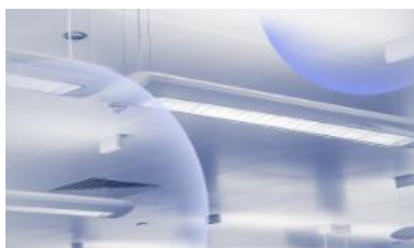
Figura 18 – Iluminação eficiente Fonte: Website da EDP
