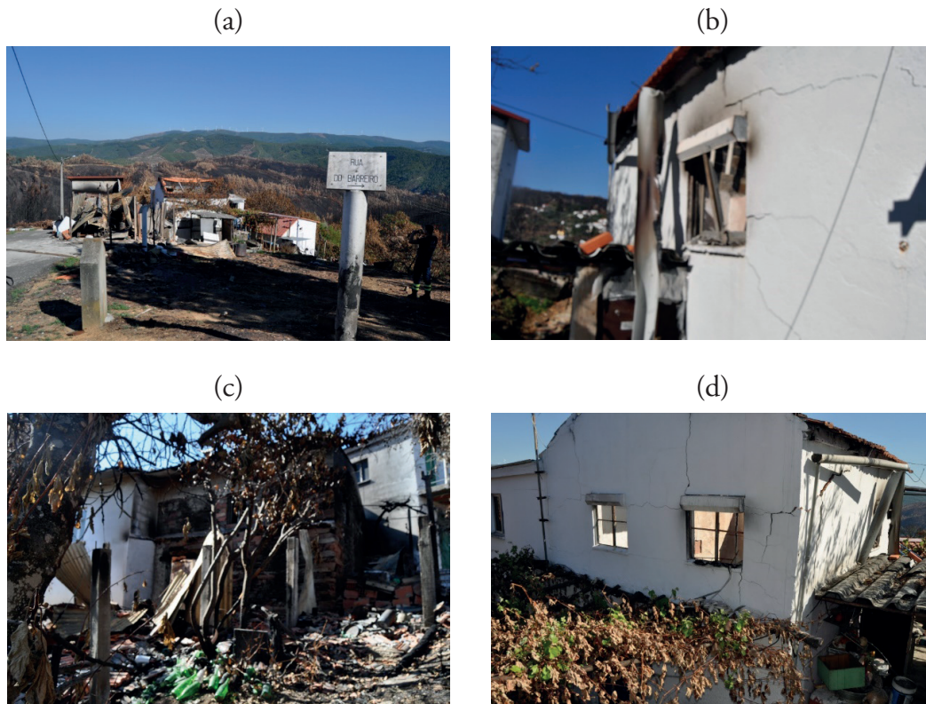
FIGURA 3: Fotografias expondo fragilidades construtivas em casas afetadas pelos incêndios de Pedrógão Grande que teve início a 17 de junho de 2017
